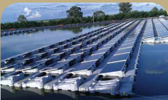
Placas solares em superfície de água
